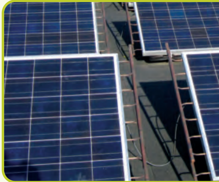
Solcellene fra taket på Valby Skole kan produsere både varme og strøm.
