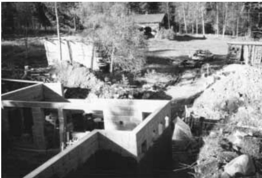
Bikhol, Tinn Austbygd – høsten 1999. Arbeidet med grunnmuren er godt i gang og materialene lagt i stabler til tørking. Bak skimtes gamlestua
